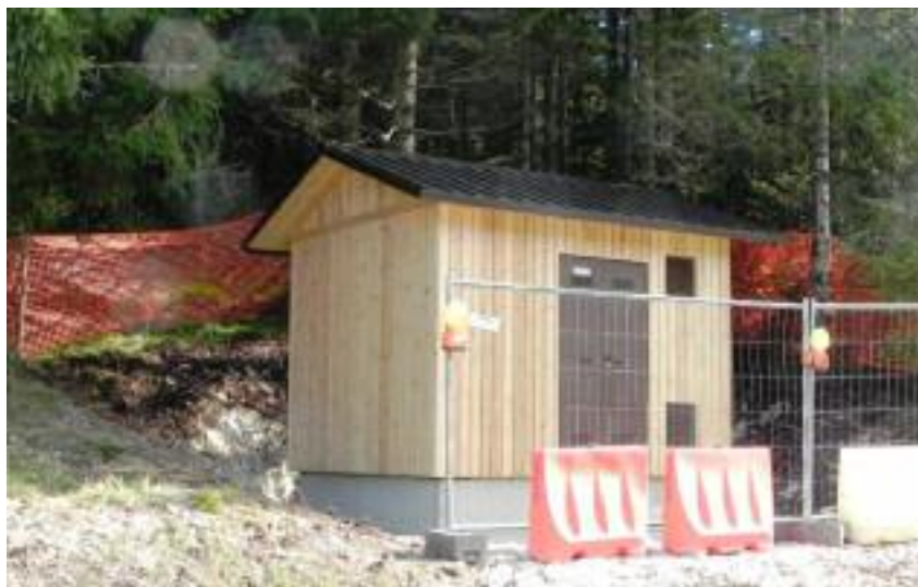
La nuova cabina SET a Monterovere
