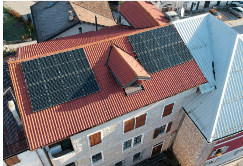
Impianto fotovoltaico per la produzione di energia elettrica posizionato sul tetto del Municipio
